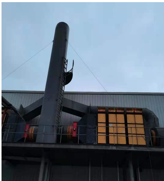
厂区现有高压静电净化器
